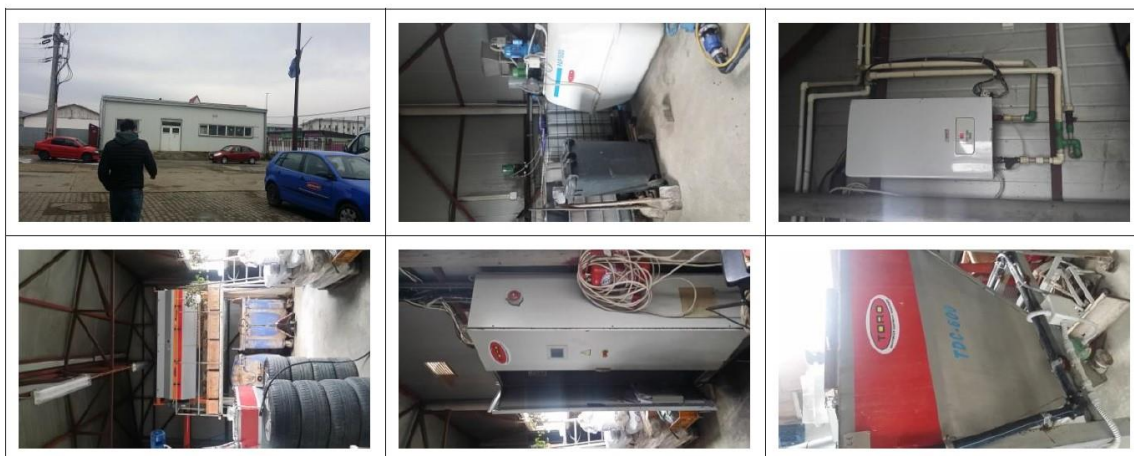
elemente din statia de epurare
